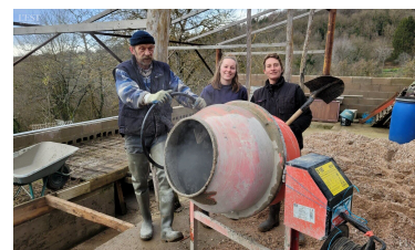
« Michou », Charlotte, l'apprentie « rayon de soleil », et Amandine ont entrepris de couler la chape du futur quai de traite. Les jeunes femmes ont trimballé 9 tonnes de sable et 50 sacs de 25 kg de ciment. Photo ER
