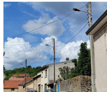
Les luminaires dotés de LED et conformes aux normes en vigueur sont installés rue de la Libération.
