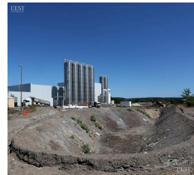
Chantier du futur site de la société Aloxe, fournisseur de plastiques recyclés haut de gamme au parc d'activités Moselle Rive Gauche de Messein. Photo Fred Marvaux
