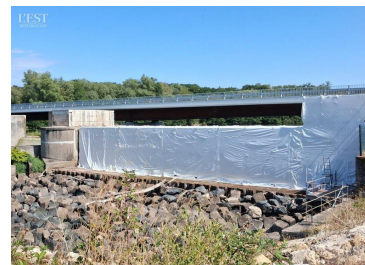
L'écoulement hydraulique interrompu laisse apparaître l'enrochement du lit de la Moselle. Photo Dominique Masson
